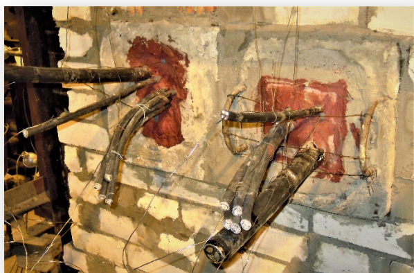
а) проходка ГЕРДА-ПБ-FR (справа) и ГЕРДА-ПМ-FR испытательной печи. Вокруг кабелей видны термопары
